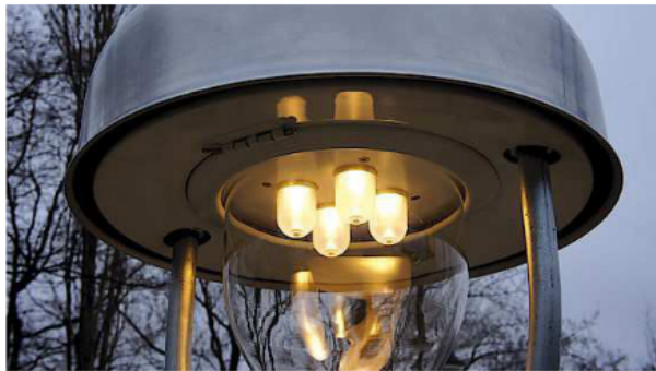
Auf LED-Leuchtmittel umgerüstete Gaslichtleuchte
